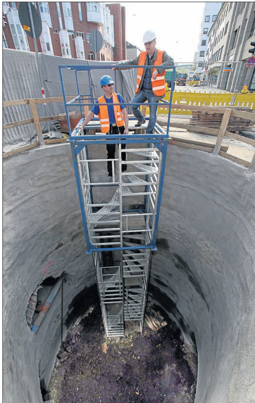
Blick in Tiefe: Stefan Wunderlich (links) von der Firma Hermanns und Bauleiter Jochen Feldle inspizieren den fast acht Meter tiefen Stolleneinstieg. Fotos: Koch
